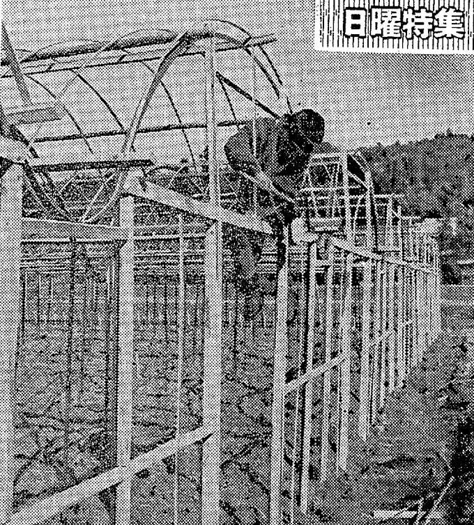
移動に便利のように上部は軽量鉄骨 下部は木材を使っているが、これにビニールを張ればでき上がり
