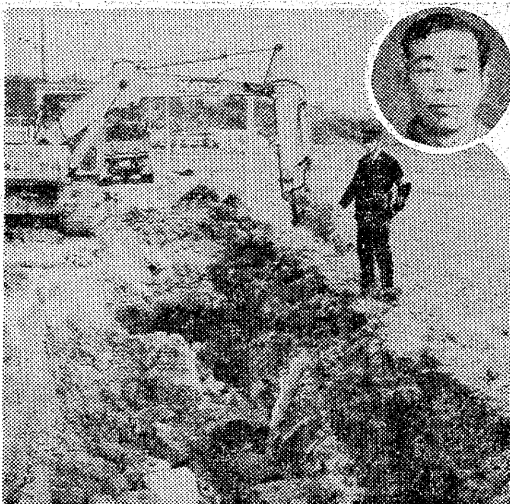
九日午後一時ごろ、いわき市平字平中塩字岸地内の水道管配管工事現場で、同市三和町下井字中山二五二、丸新山作業員松本忠三さん(右)と同市内白川平六、同作業員湯川勘三郎さん(左)の二人は埋設溝(幅一・五尺、長さ五尺、深さ二尺)で止まる作業をしていて、突然土砂が崩れ、埋設溝の中にはいり、土砂が押しつぶされた。九日午後一時ごろ、いわき市平字平中塩字岸地内の水道管配管工事現場で、同市三和町下井字中山二五二、丸新山作業員松本忠三さん(右)と同市内白川平六、同作業員湯川勘三郎さん(左)の二人は埋設溝(幅一・五尺、長さ五尺、深さ二尺)で止まる作業をしていて、突然土砂が崩れ、埋設溝の中にはいり、土砂が押しつぶされた。
