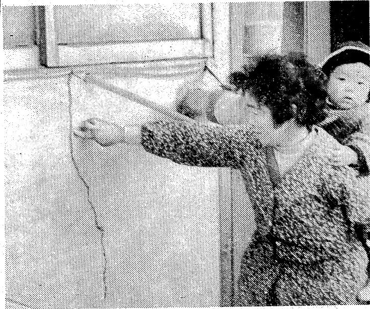
ヒビ割れた新築家屋の壁
