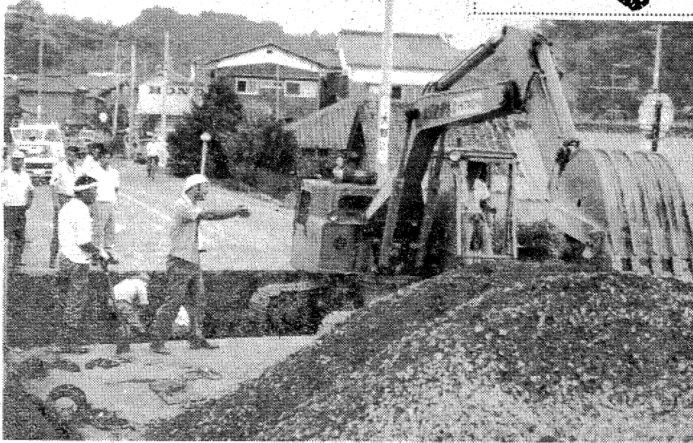
▲16日に平北目地内の県道いわき~小川線の平川橋際(写真)が陥没して水がふき出し 10戸が断水になったほか17日昼前まで通行止めになりう回する車で大混雑した 17日には平川橋から30メートル離れた市道の中央で水道管が破れ1256戸が断水するなど 水道事故が目立っている
