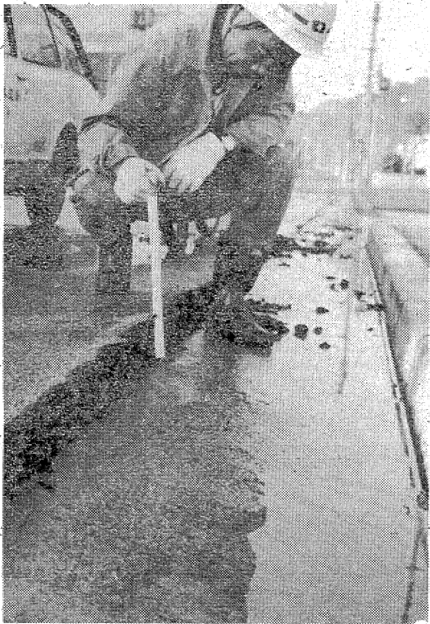
▲地震があつて間もない15日午前3時半ごろ 平の官庁街の聯安通りの水道幹線が破裂し 厚さ10センチのアスファルト舗装を持ち上げて7カ所から水が噴出する事故があつた (写真は水圧でめくれ上がった舗装)
