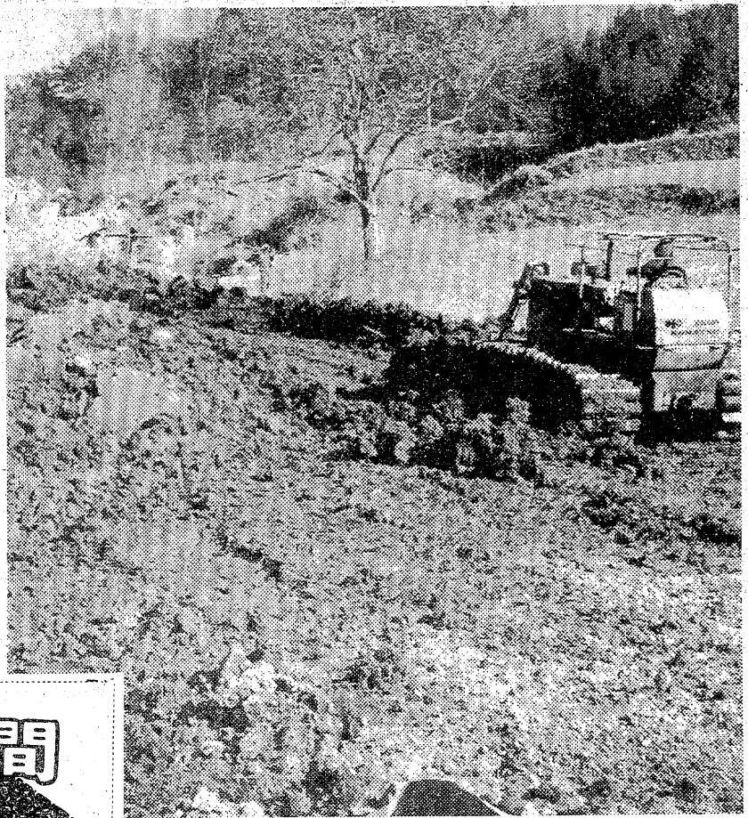
▲「地震と長雨が引き金」といわれる昨年10月19日の四倉町栗木貯水池の決壊は、下流の家や田畑などに大被害を出した。その後の調査で、現場一帯の山は不整合状態の地層のため、今後も地滑りの可能性があるため、県は「地滑り防止区域」に指定。このたび大掛かりな治山工事に着手した。
