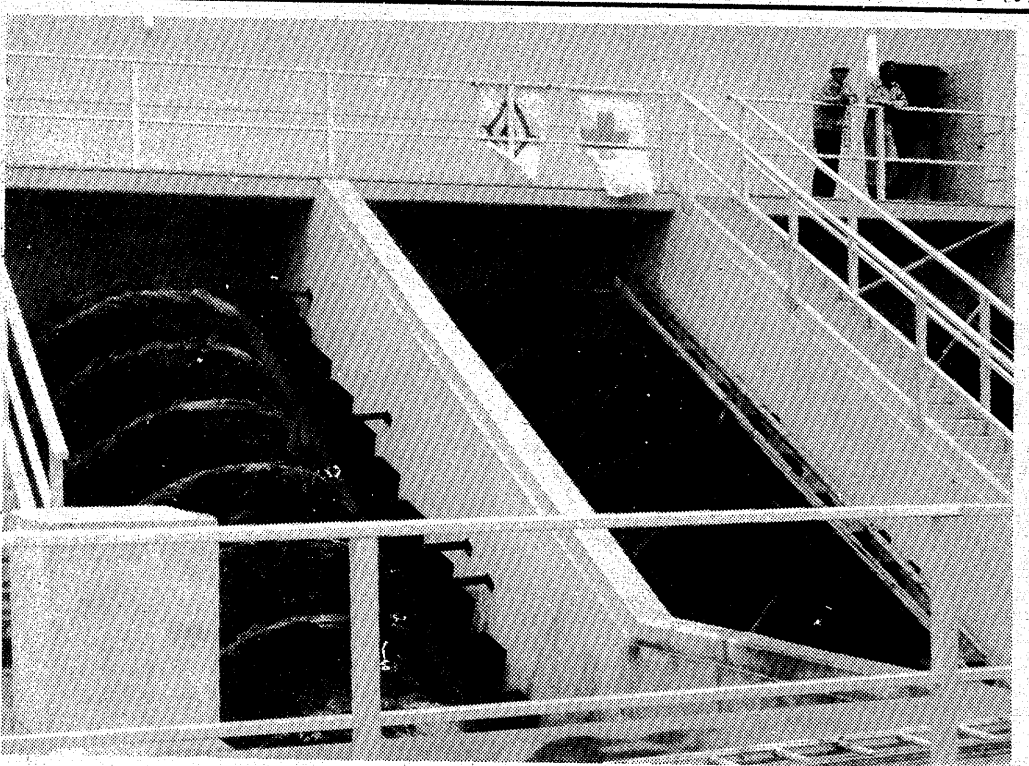
▲小名浜地区を小名川のはんらんと海水の逆流による水害から守るため、市では河口に排水ポンプ場を建設。併せて河川改修工事も進めている。川水を海へはき出す主役のスクリーは排出能力が1分間に約300トで、これは中学校の25メートルプールの水約450トを1分半でからにするものすごいやつだ。
