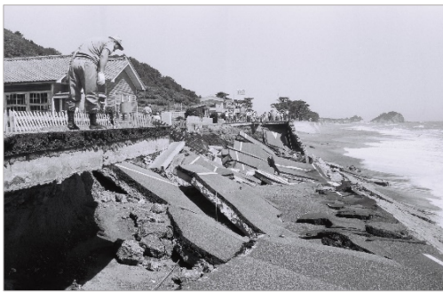
←台風13号により久之浜町田之網地内の国道が被災
