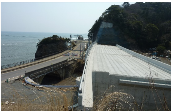
久之浜町田之網字江之網の国道6号と同バイパス建設を北側から見る
