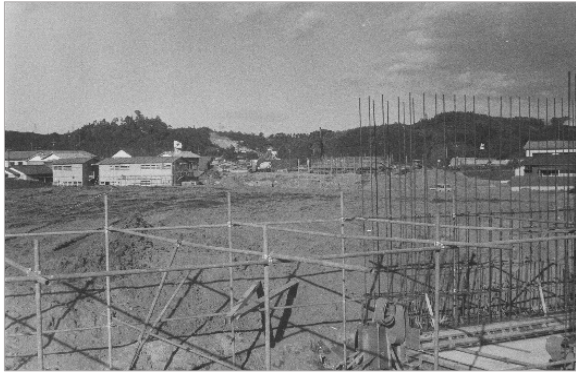
国道6号常磐バイパス佐糠町地内の建設を南側から見る (昭和45年11月、いわき市提供)
