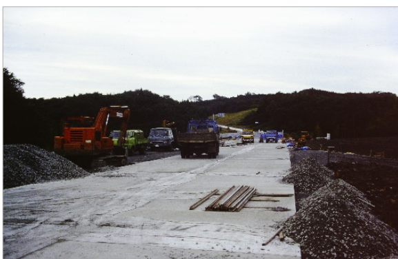
国道6号常磐バイパス建設・常磐三沢町を北側から見る (昭和60年7月、いわき市提供)
