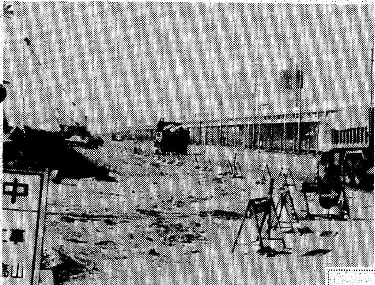
▲小名浜港の港湾道路は2号ふ頭から4号ふ頭までは上下6車線だが、高山地内の4号ふ頭から上り車線は2車線に狭まっている。このため、小名浜港の整備を進めている小名浜港湾建設事務所では、同区間の拡幅工事を実施中で、上り車線、歩道や停車帯が新設される。
