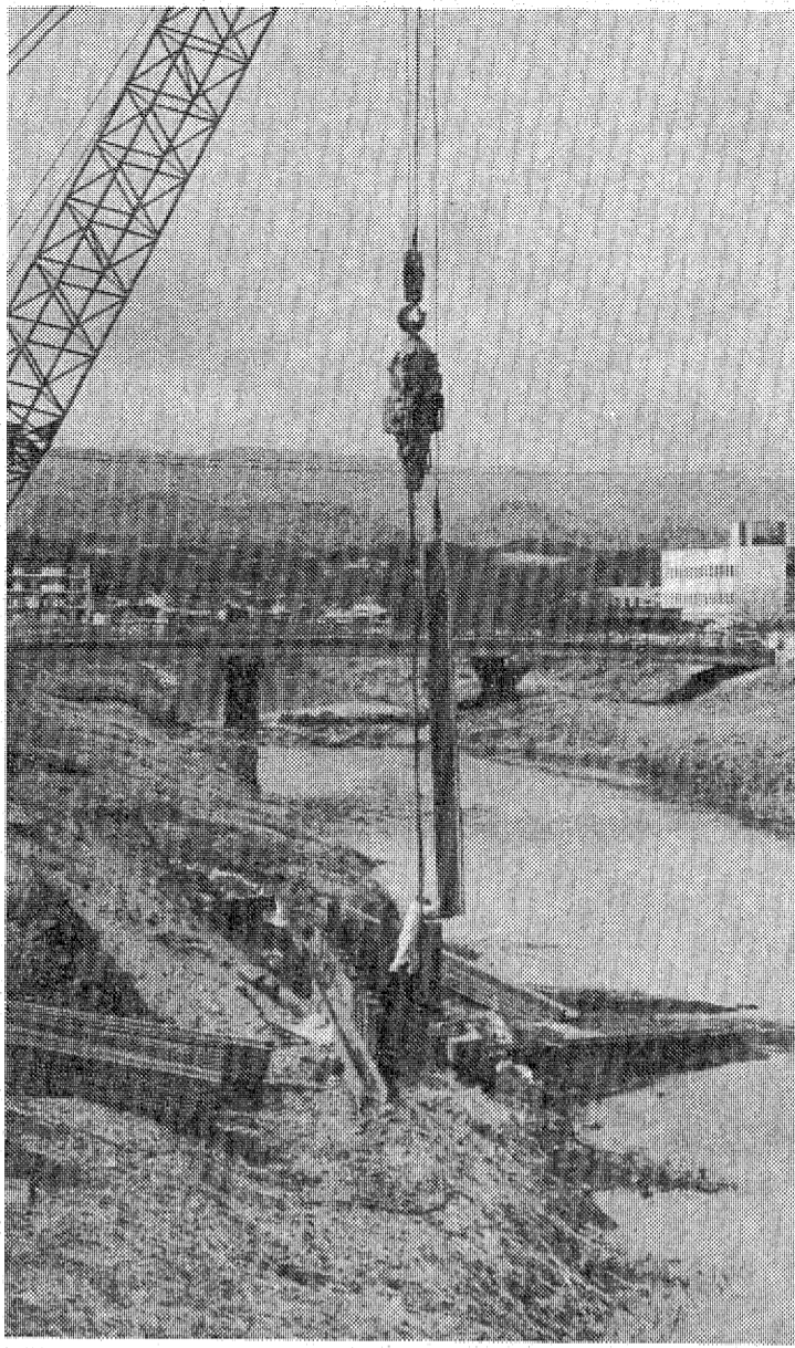
完成間近い平・明治町の排水ポンプ場
