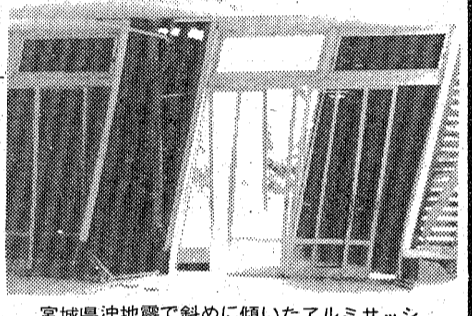
宮城県沖地震で斜めに傾いたアルミサッシ
