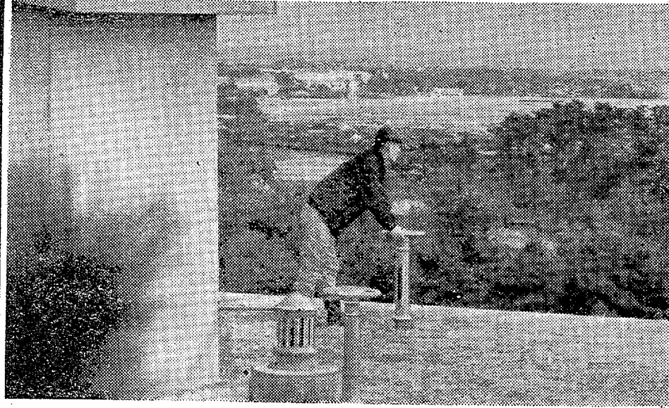
安養寺山頂の配水池から受益地帯までをむき 水源池からパイプでここに湯水し消毒殺菌して配水する
