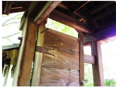
銃弾による穴が残る山門(良善寺)
