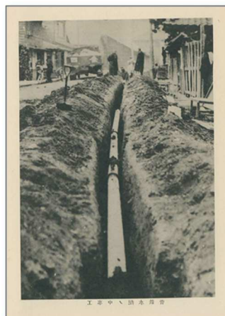
工事中ノ配水鉄管 『四倉町上水道抄誌』 四倉町水道部 昭和 12(1937)年
